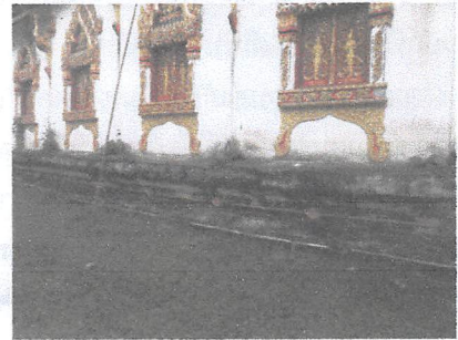
โครงสร้างของวัดต้องได้รับการบูรณะโดยด่วน
